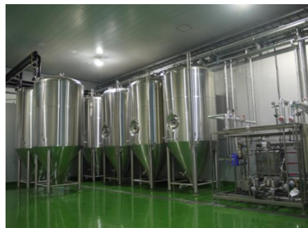
缶ビール製造機器の設置
