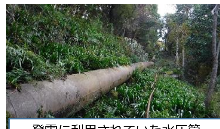
発電に利用されていた水圧管
